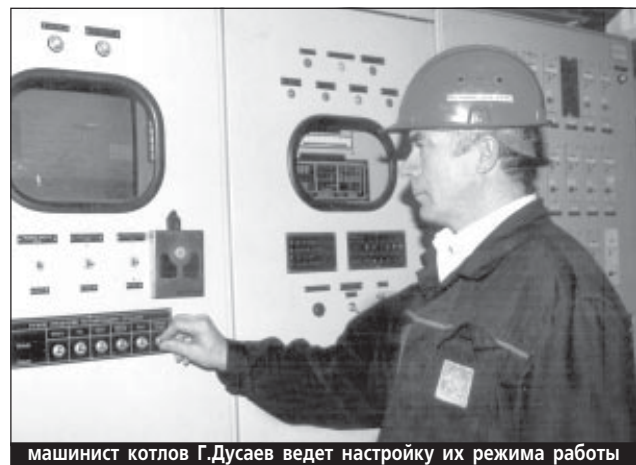
машинист котлов Г.Дусаев ведет настройку их режима работы
